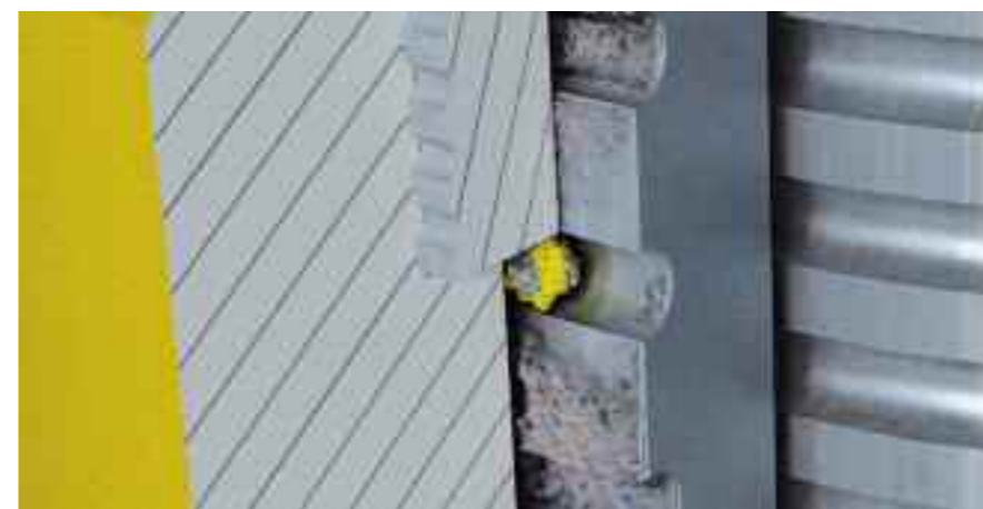
Fig. 8 - Presenza di ruggine e corpo estraneo
