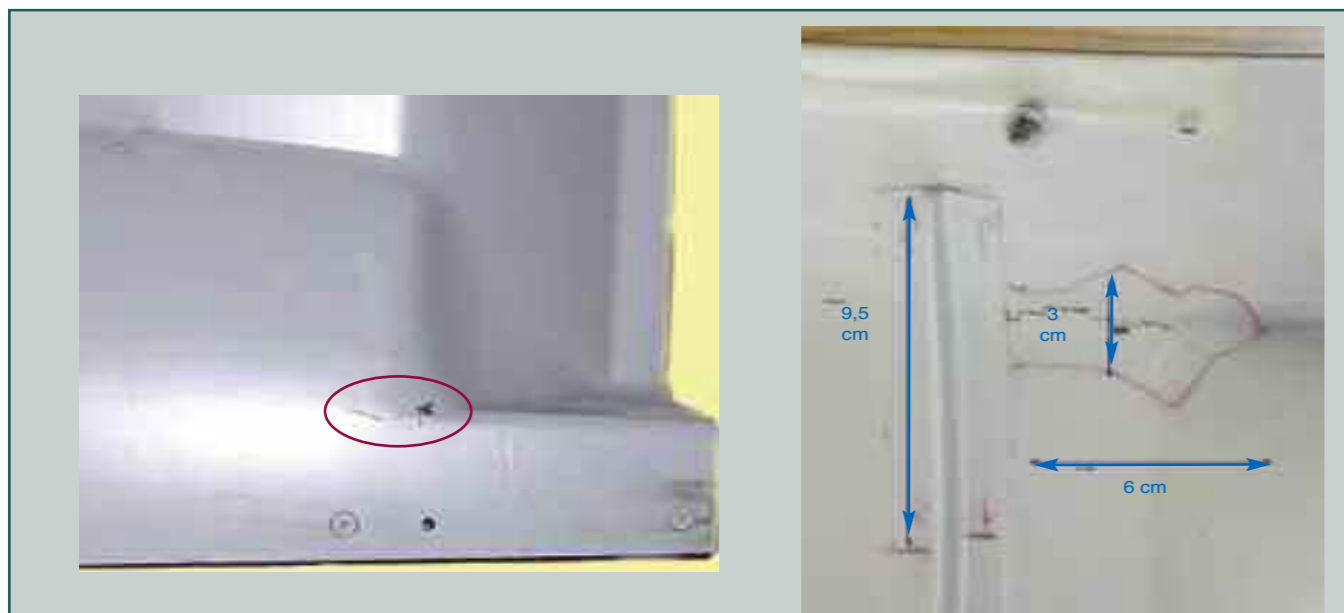
Fig. 13 - EF2000 Pre-cooler fairing 343 - vista esterna ed interna della zona soggetta a rottura
