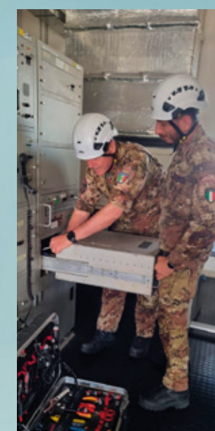
Fig.4 Installazione apparati radio TBT UHF presso il sito radio di Capo Frasca
