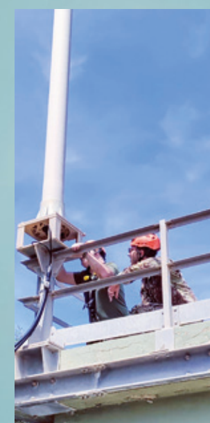
Fig.3 Controllo tecnico di efficienza dell'antenna VHF a 2 dipoli presso il sito radio di Capo Frasca
