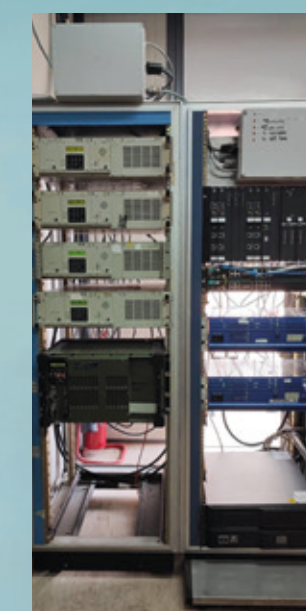
Fig.5 Apparati radio e centrale MT301F installati presso il sito di Punta San Michele
